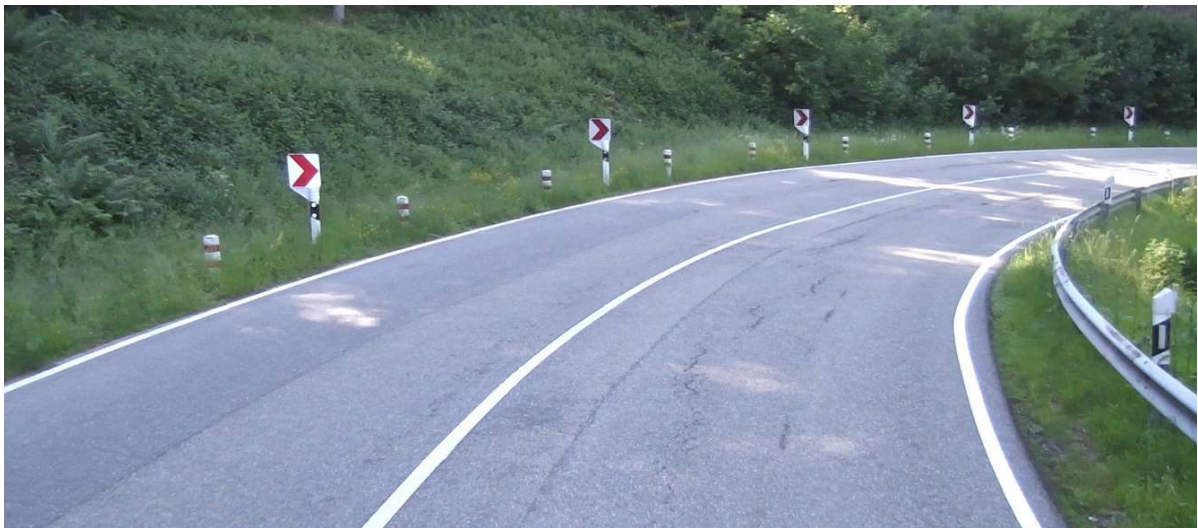
Bild 4: Kurvenleittafeln und Balisetten im Vergleich (Quelle: ZEB Befahrung 2015) – Hinweis: Aufstellung nicht regelkonform auf Leitpfosten
